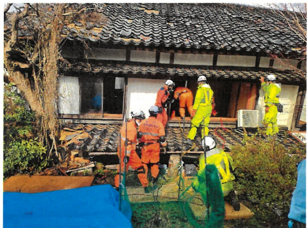
令和6年能登半島地震 倒壊した家屋で要救助者を捜索する隊員
